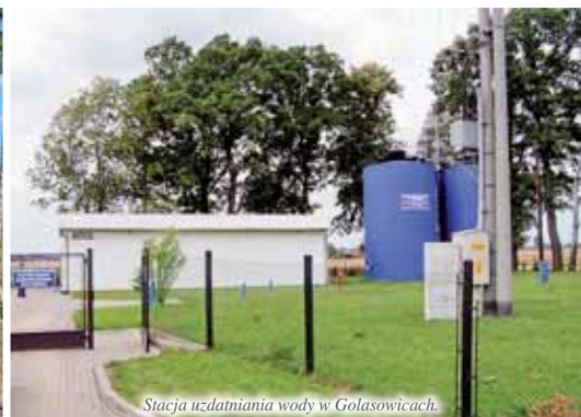
Stacja uzdatniania wody w Golasowicach.
