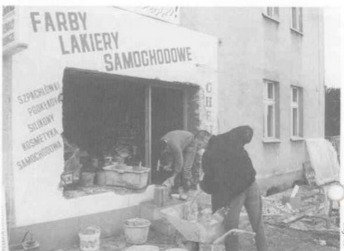
Autobus zniszczył drzwi działającego na parterze sklepu z farbami oraz ścianę, za którą spał mieszkaniec Pawłowic.
