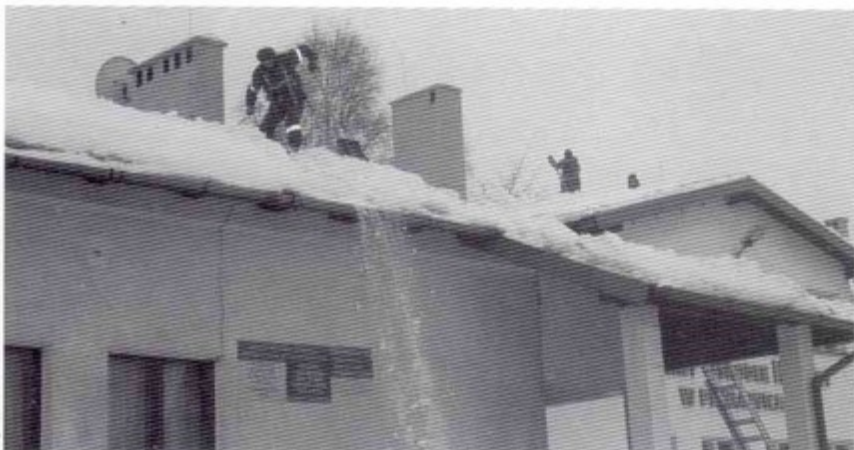
zdf, sb Brygada GZK usuwa śnieg z dachu Gminnego Ośrodka Kultury w Pawłowicach.
