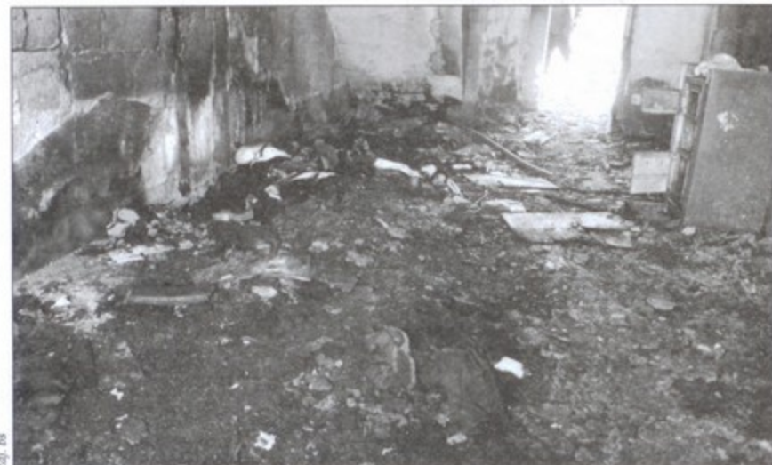
Parter jednorodzinnej domu spłonął doszczętnie.
