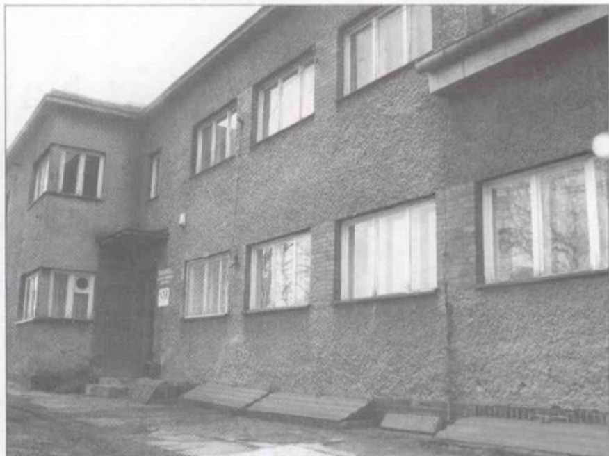
Obecny stan budynku Ośrodka Zdrowia w Krzyżowicach pozostawia wiele do życzenia.
