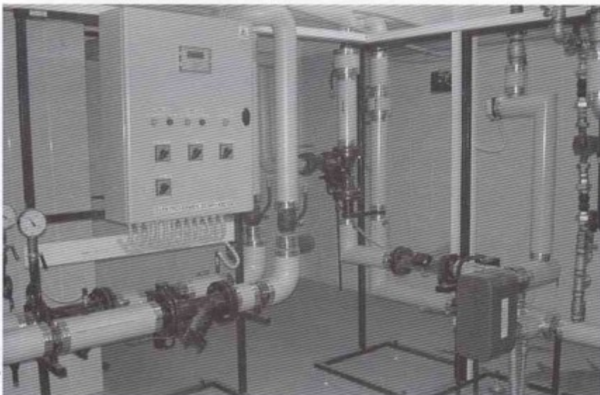
Tak wygląda nowa kotłownia w liceum.
