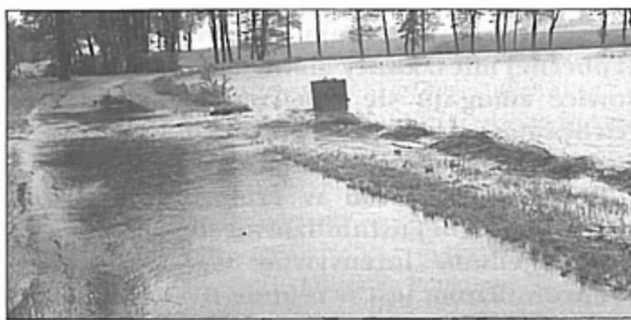
Przez wiele dróg przelewała się woda, uszkadzając nawierzchnię i pobocza.
