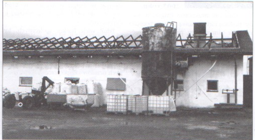
W pożarze spaliła się konstrukcja i pokrycie dachu kurnika.
